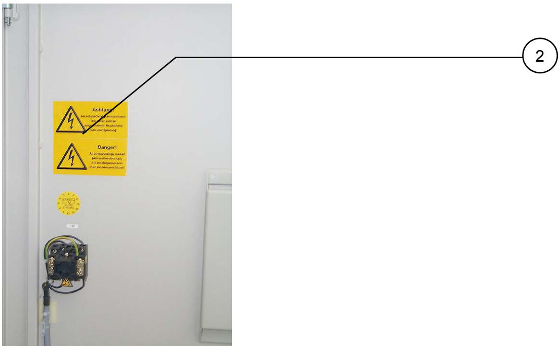
Abb. 3 - 7 Warnschilder im Schaltschrank
