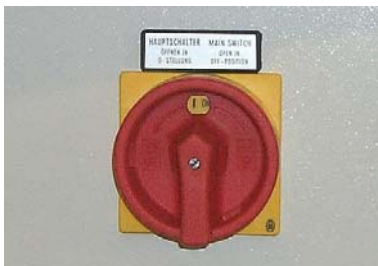
Abb. 3 - 2 Hauptschalter und Not-Halt-Schalter
